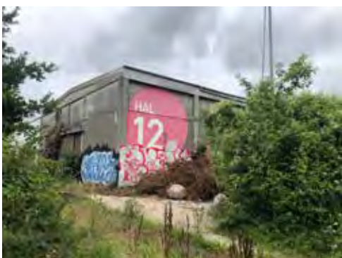
Fig.23. Hal 12 fremstår i dag med fremskudte søjler og bjælker i beton og tilbagetrukne facadepartier (fag). Facadepartierne kan udskiftes, mens de bærende konstruktioner skal bevares.
