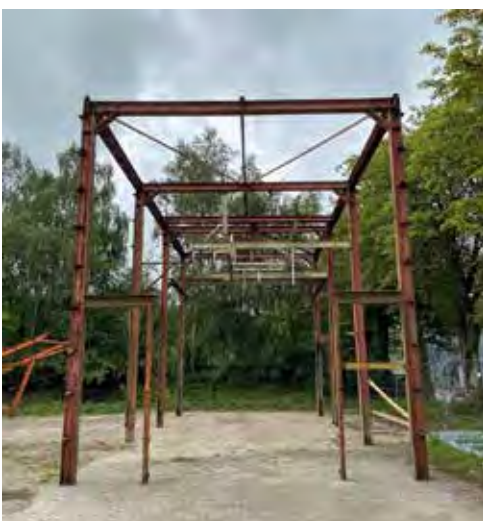
Fig.20. Trappeforløbet kan integreres i de stålkonstruktioner, der tidligere har udgjort tårnet til Hal 12. Tårnet udgøres af to stålkonstruktioner, hvor den ene ses her.
